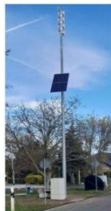
Beispiel für eine Sirene auf Mast
